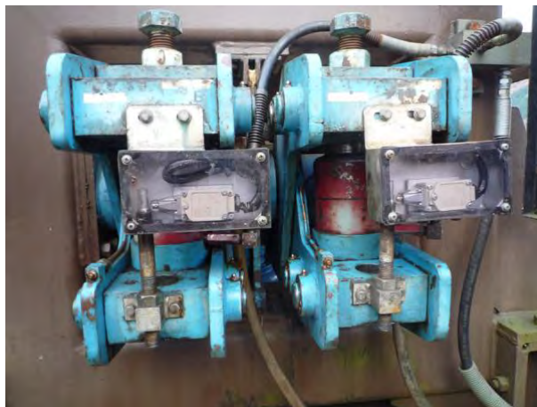
<非常制動機分解整備>
